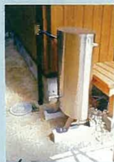
雨水貯留タンク
