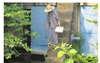
大見川合流部の段差の状況
