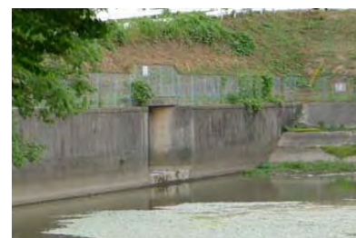
長池ー承水溝の段差
