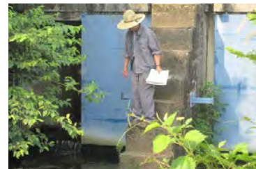
大見川合流部の段差の状況
