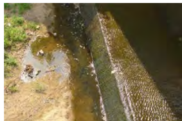
加茂川水門の段差の状況
