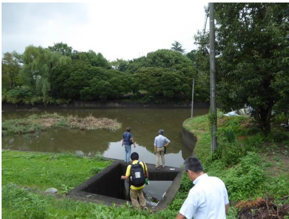
図 7 ひょうたん池周辺の段差確認
