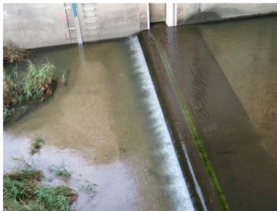
図1 加茂川水門の段差状況
