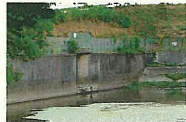
長池一承水溝の段差
