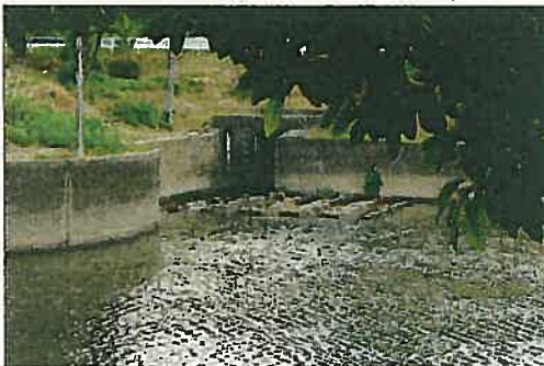
①家下川一承水溝の段差
