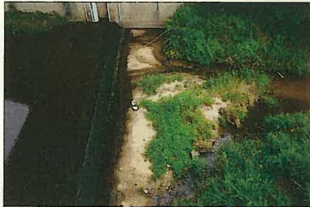
図 1 加茂川合流点段差の状況
