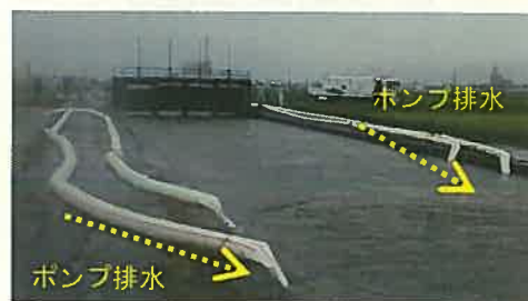
洪水時における支援状況 (排水ポンプ車による排水活動 豊川市 平成27年9月)
