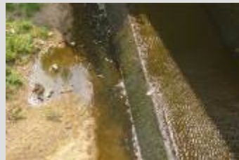
加茂川水門下の段差の状況
