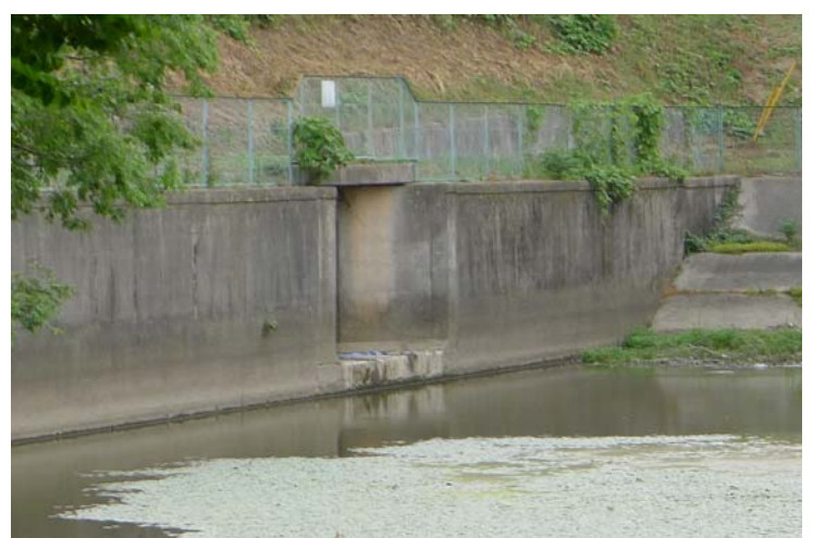
③承水溝－長池の段差 (承水溝側)
