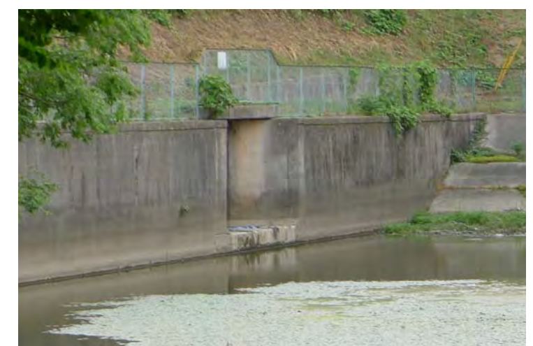
③承水溝－長池の段差 (承水溝側)
