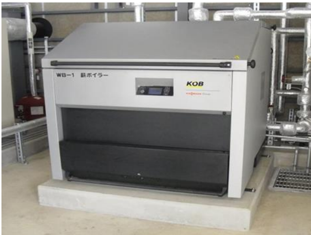
根羽村役場の薪ボイラー
