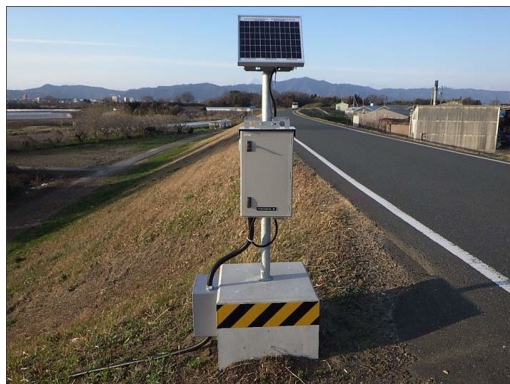
危機管理型水位計の外観
