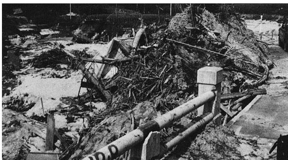
全壊流失した東市野々公民館
