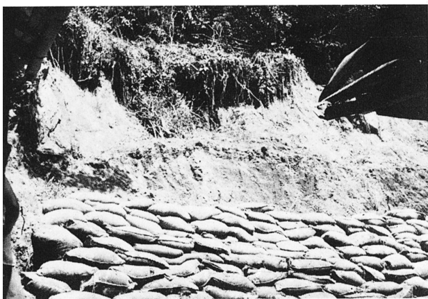
清原小学校給食室裏山の崩壊
