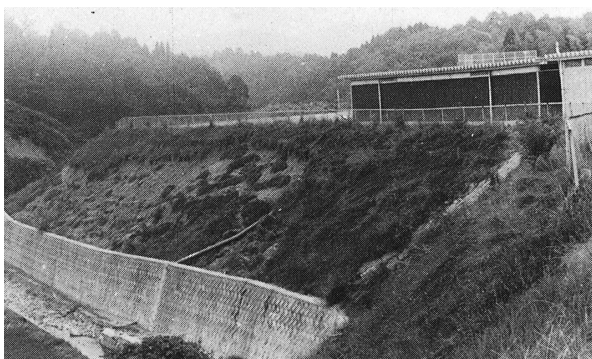
はみだした村民運動広場の擁壁
