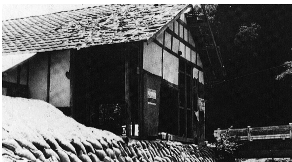
土台下を洗われた大ヶ蔵連公民館
