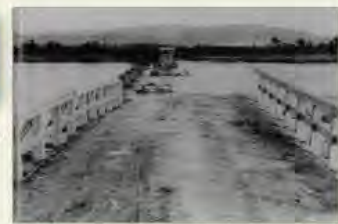
S34洪水/岡崎市美矢井橋の被災状況
