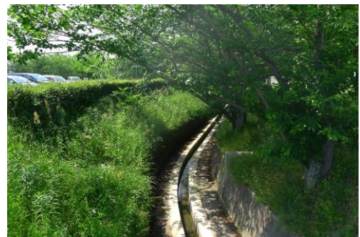
U字溝排水路
