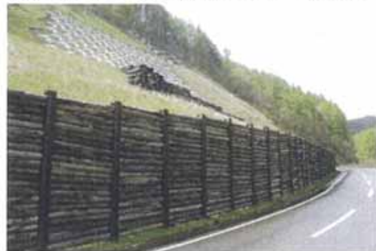
写真-7 木製落石防護柵
