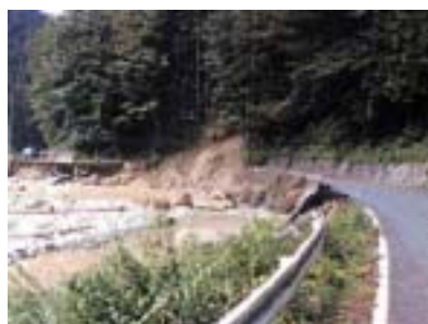
河岸決壊による道路流失 飯田洞川・上矢作町萩原
