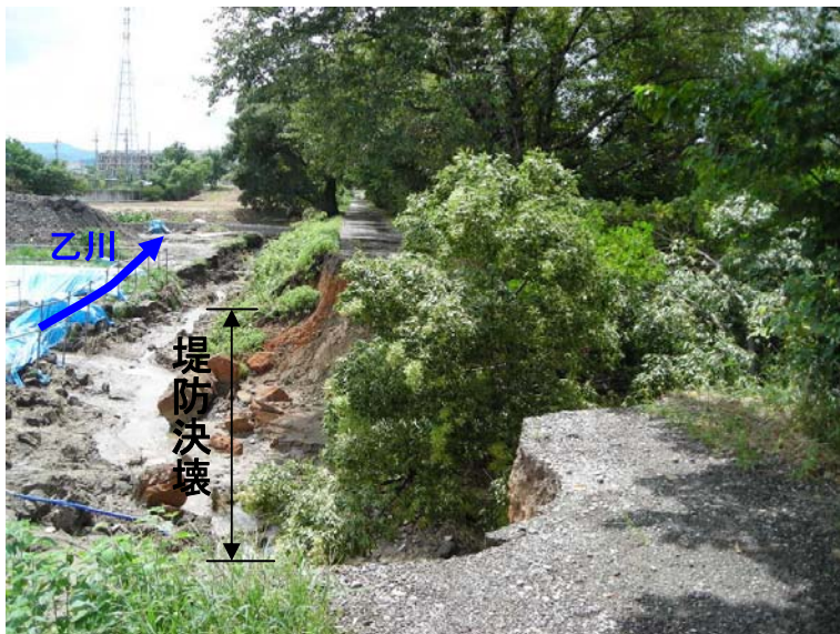
乙川右岸堤防決壊 岡崎市大平町地先
