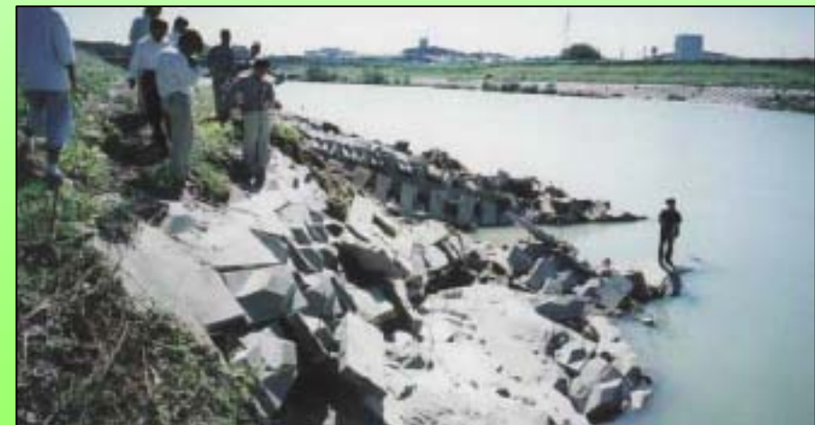
東海豪雨時に被災した矢作川の護岸 (左岸38km 付近、土木学会HP)
