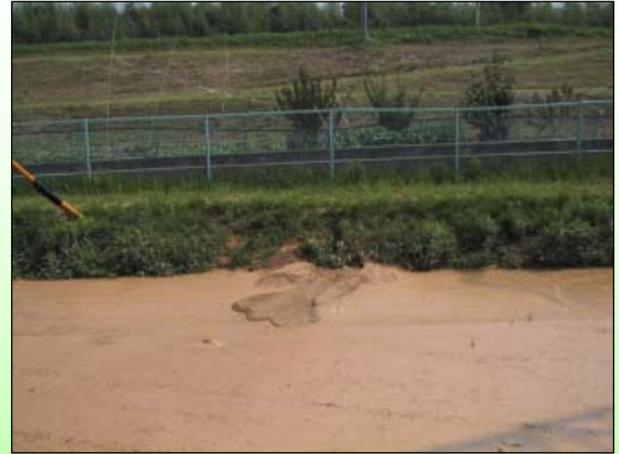
漏水状況 右岸38.8k 付近
