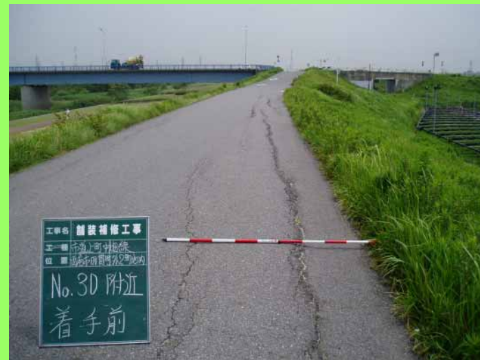
堤防天端のクラック (矢作川左岸6.0k付近)
