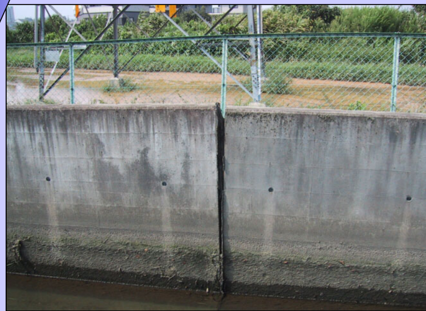
水路が浮き上がったため、継ぎ目が広がった。
