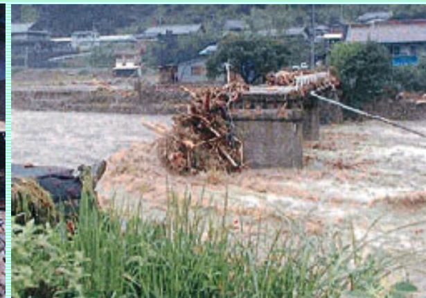
落橋した越沢橋(上村川・上矢作町漆原)
