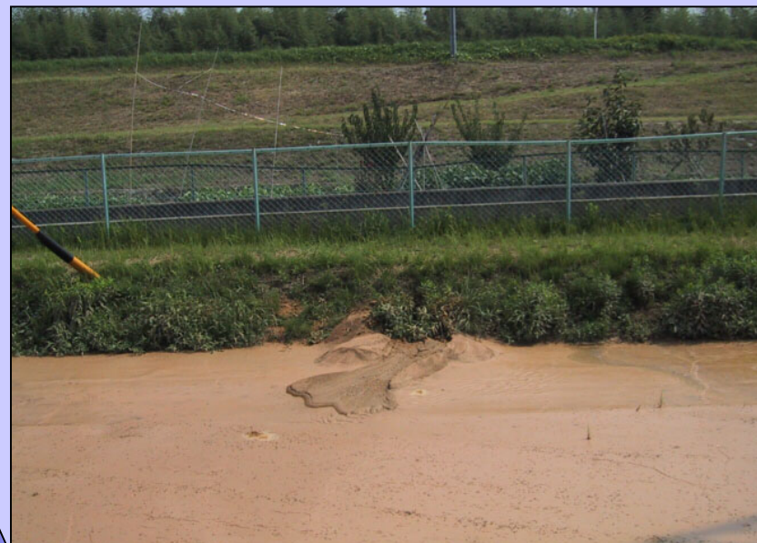
右岸38.8K+50附近 安永川水路横の堤内側の吹出穴
