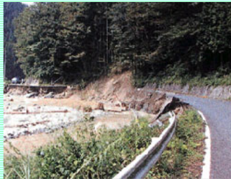
河岸決壊による道路流失 (飯田洞川・上矢作町萩原)
