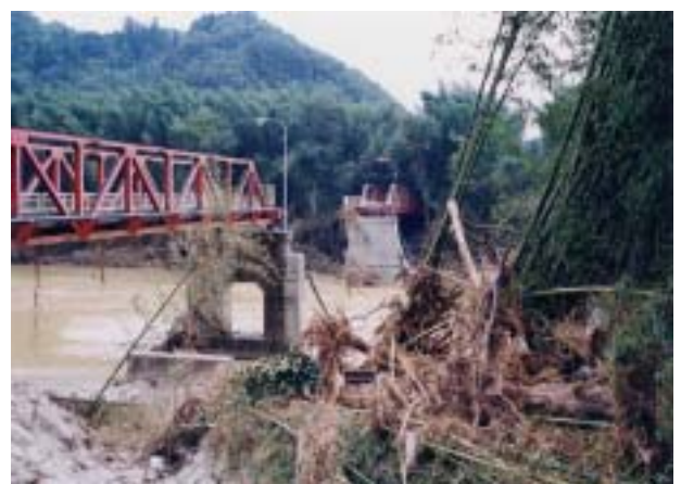
愛知県豊田市 流出した富国橋
