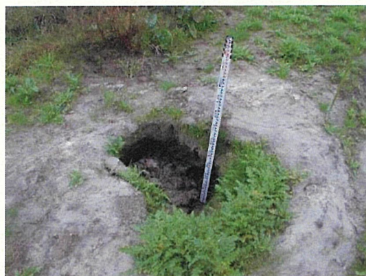
矢作川右岸38k付近 埴内地(畑)での漏水状況
