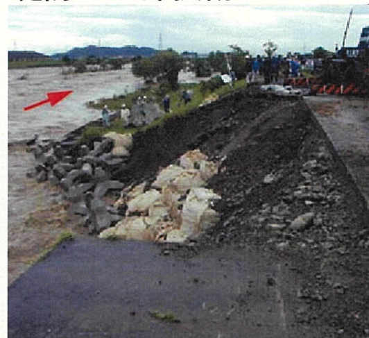
堤防の一部損傷
