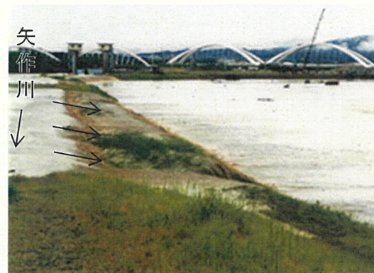
豊田市御立町(矢作川左岸)越水状況
