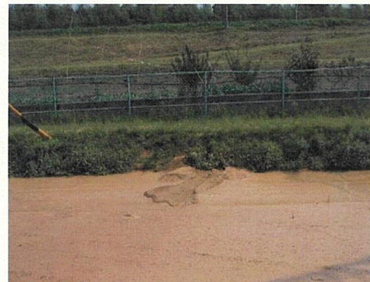
矢作川右岸38.85k付近 安永川右岸での漏水状況
