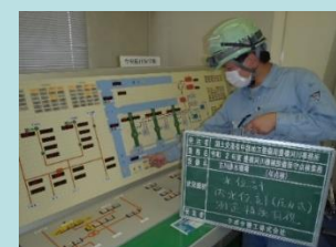
(操作設備の点検)
