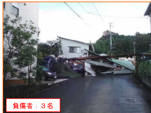
9/24 はままつしてんりゆうりよくけいだい がけ崩れ 静岡県浜松市天竜区緑恵台
