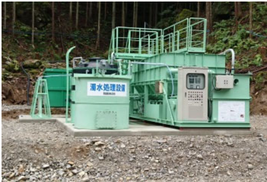
濁水処理施設
