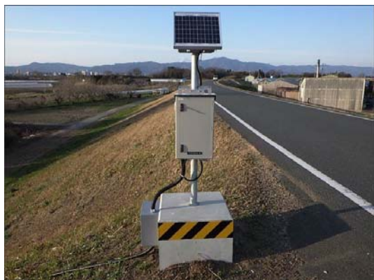
危機管理型水位計の外観
