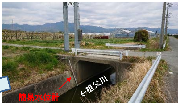
簡易水位計(CCTV (金沢霞堤内) 付近)
