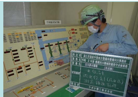
(操作設備の点検・操作講習)
