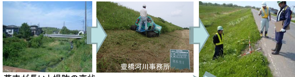
草丈が長いと堤防の変状が分からない
