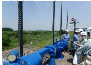
機械設備の定期的な点検
