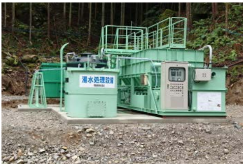
濁水処理施設
