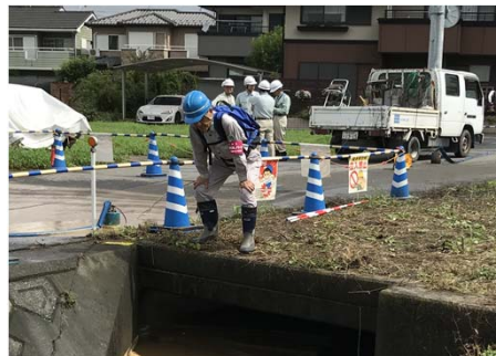
防災エキスパート 被災状況の確認
