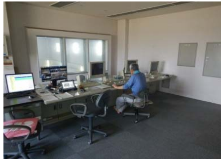
岐阜市 排水機場の操作
