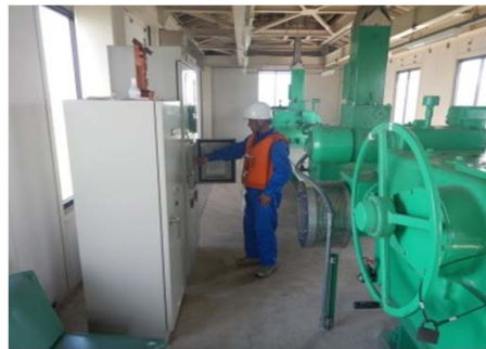
岐阜県 排水樋門の操作
