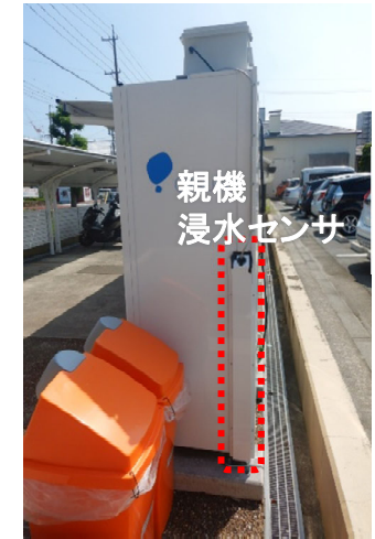
<自動販売機側 浸水センサ 1段>
