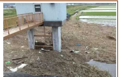
河川管理施設周辺の堆積事例
