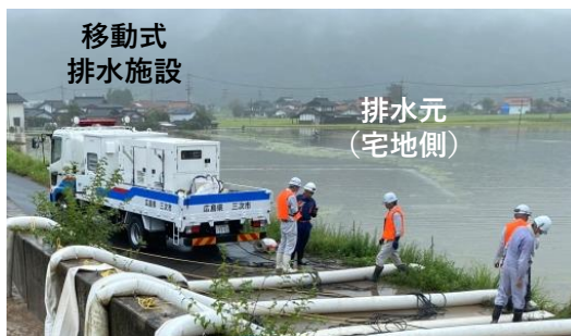
普通河川の管理者による排水状況（三次市） ※移動式排水施設は市が管理
