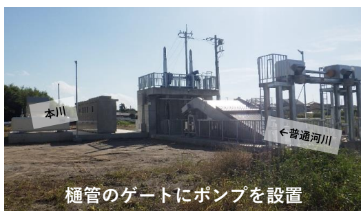
普通河川の管理者による排水施設の設置（茂原市）
