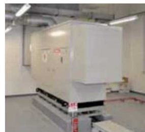
非常用発電設備のイメージ
