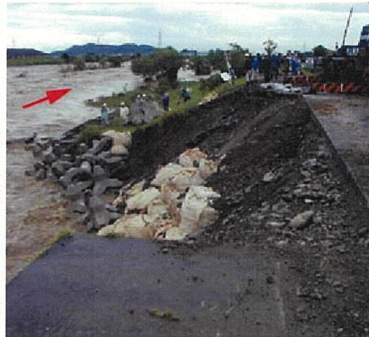
堤防の一部損傷
