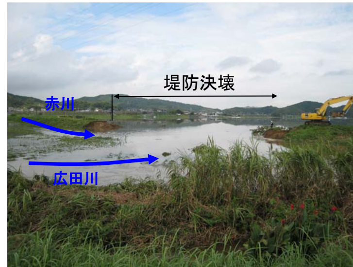
広田川堤防決壊(右岸より左岸を望む)
