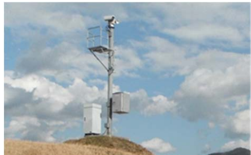
CCTV カメラ設置イメージ
