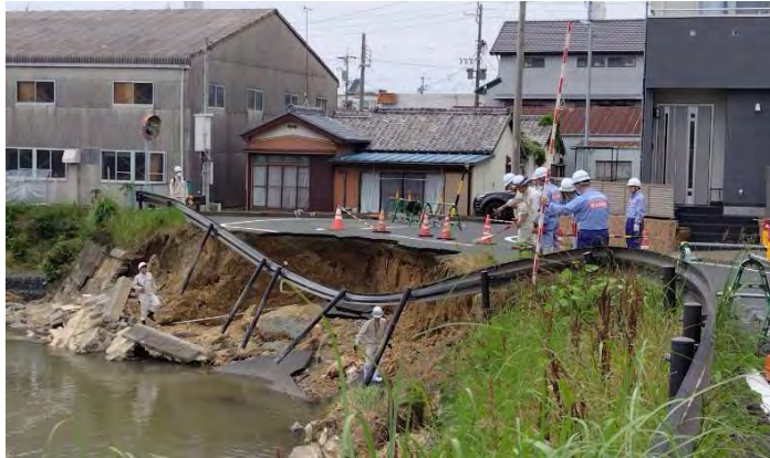
②山中川の被災状況調査
