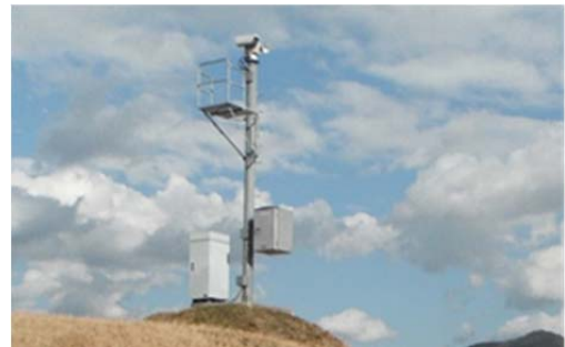
CCTV カメラ設置イメージ
