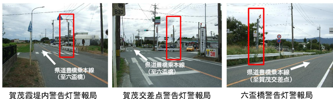
図 3.3 回転灯および案内看板の設置状況（賀茂・三上地区）
