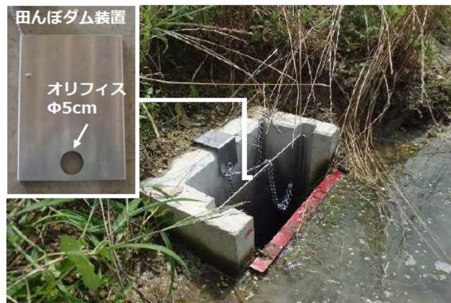
▲排水マス流量調整方式の外観
