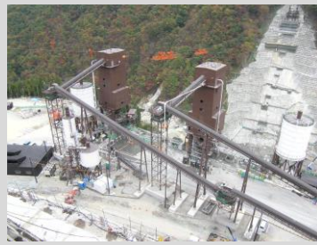
コンクリート製造プラント
