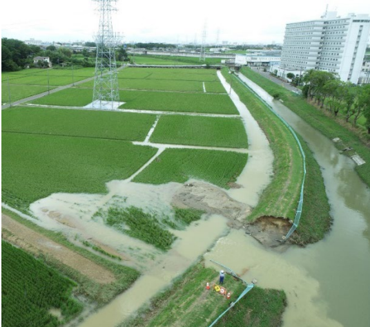
【堤防決壊状況】
