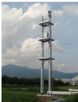
新たに設置した金沢霞堤内カメラ
