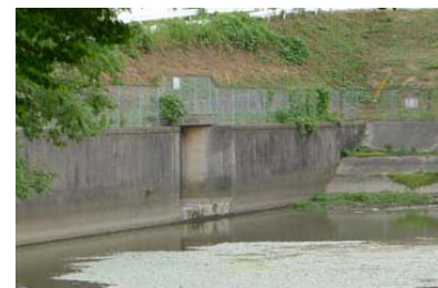
長池一承水溝の段差
