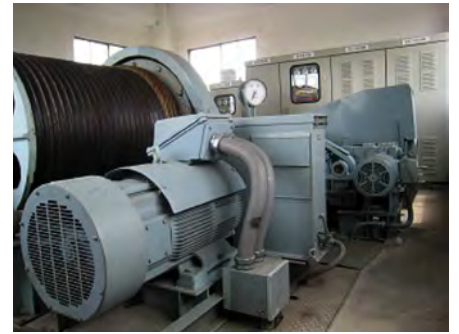
機械室内の巻上げ装置
