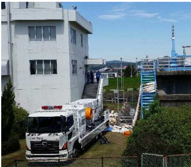
↑ 緊急配備していた排水ポンプ車
