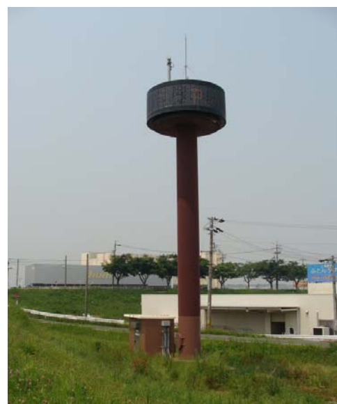
正岡警報表示板〈正岡橋(5.3k)上流右岸〉
