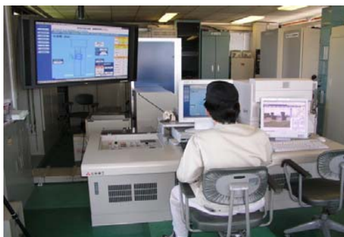
放水路管理所内での操作
