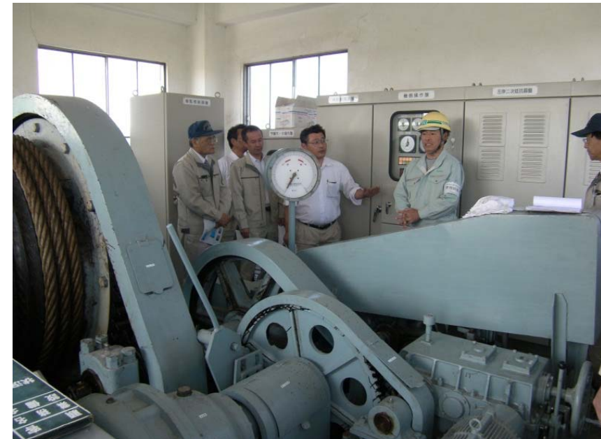
放水路可動堰ゲート操作訓練
