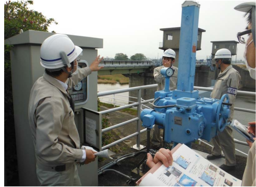
管理所前・分流堰低水樋管操作説明
