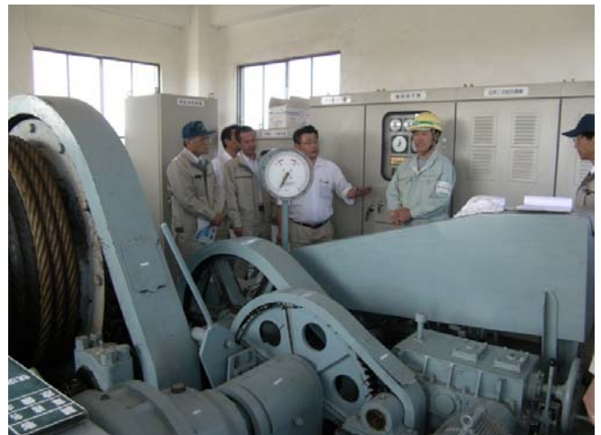
機側操作室・H22機側操作説明
