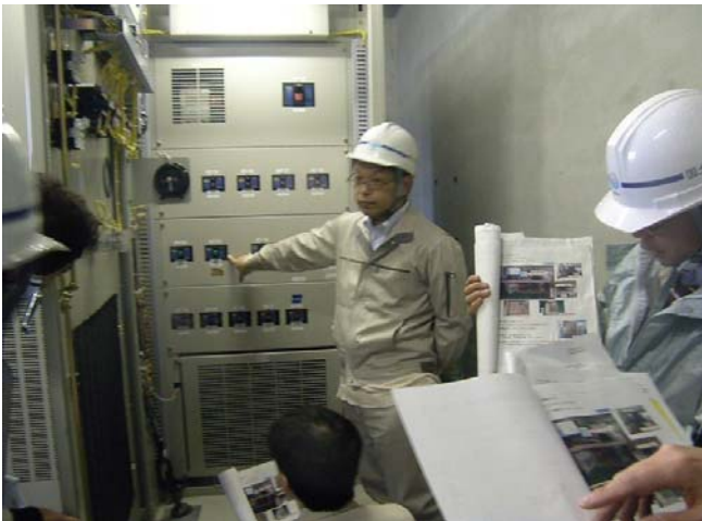
管理所内・H25電源切換盤操作説明
