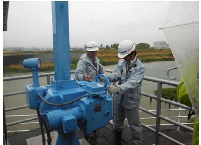
管理所前・H25分流堰低水樋管操作説明
