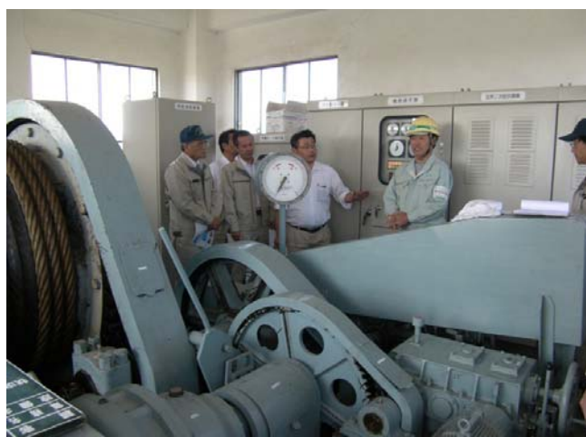
機側操作室・機側操作説明
