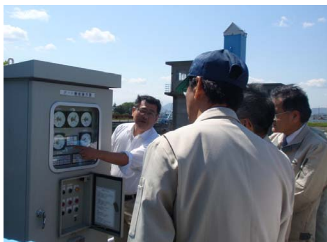
管理所前・低水樋管操作説明
